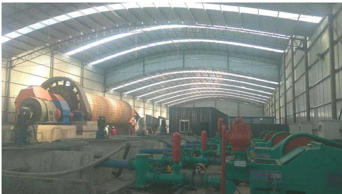
照片 3-1 采空区覆岩离层注浆站
